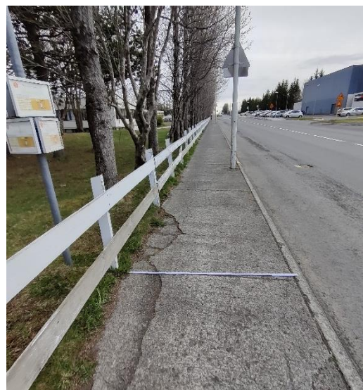
Mynd 5.4 Biðaðstaða við Vallaskóla á Selfossi, þegar ekið er í átt til Reykjavíkur. Slæmt aðgengi að tímatöflustaur, breidd gangstétta er 160 cm.
